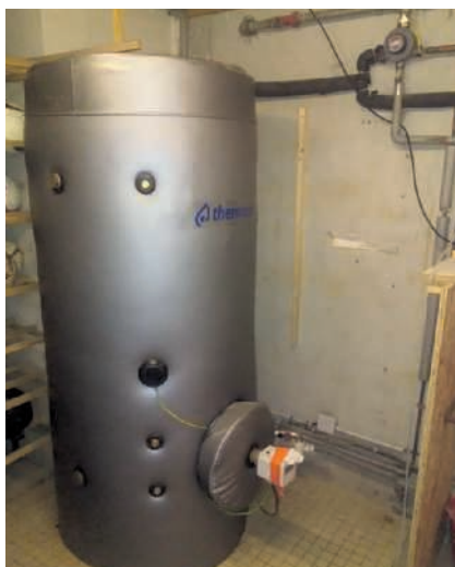
Ballon d'eau chaude
